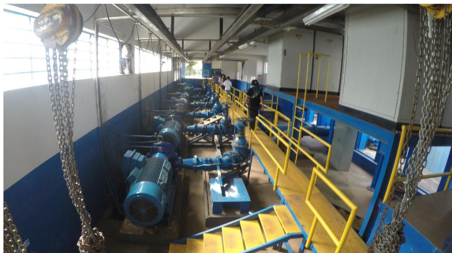
Figura 11: Conjunto moto bomba para adução da água do rio Uberaba para a ETA.
