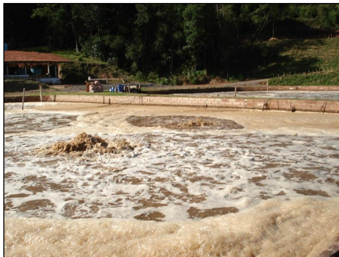
Figura 2. Sistema de lagoas de aeração com aeradores submersos.
