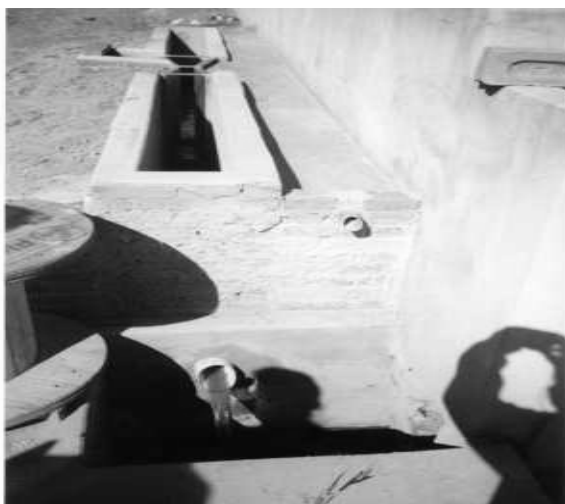
Foto 3 - Chorume já tratado
