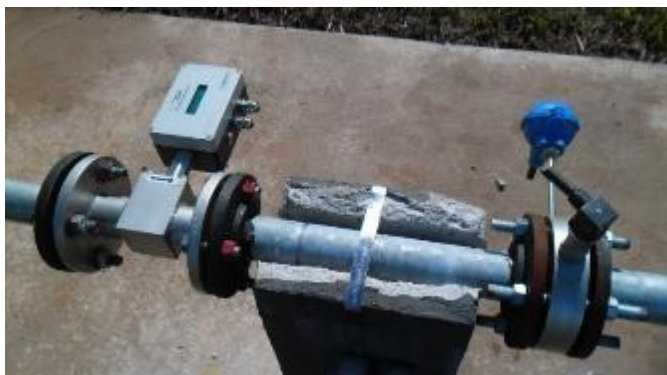
Figura 11 – Medidor da vazão de biogás instalado (esquerda) e medidor de pressão e temperatura (direita), instalado na ETE B. Fonte: Rotária do Brasil, 2015.
