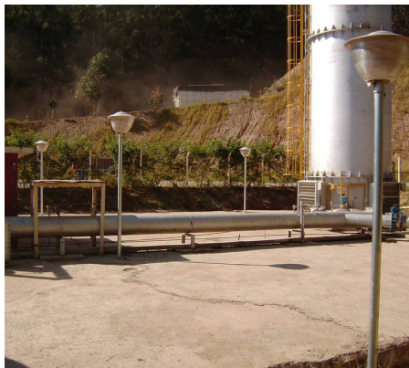
Figura 4 – sistema automatizado de iluminação a gás / automatized system of gas illumination.
